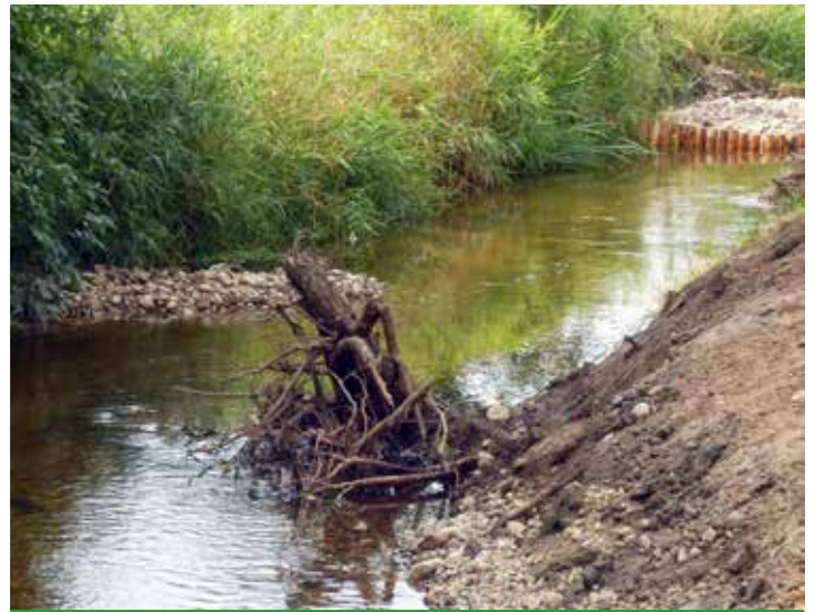
Auf der 150m langen Revitalisierungsstrecke wurden Totholz und Kies eingebracht, um neue Lebensräume zu entwickeln.
